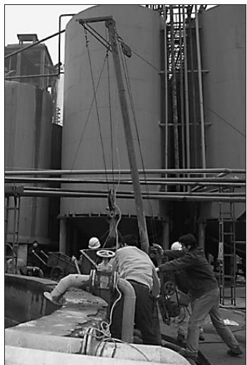
新春伊始,孟州市工业建设热潮不减,各企业通过上新项目、抓紧生产、自主创新、积极招商等方式增强企业发展后劲和市场竞争能力,保持了强劲的发展势头。图为该市河阳酒精总厂的职工正在检修设备。 郭增强 摄
