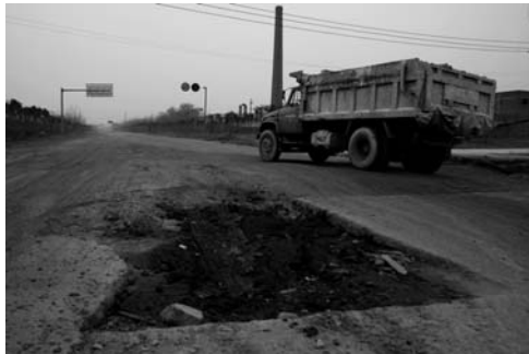
马村区银河大道路面坑洼不平，至今未修。 本报记者 王海燕 摄
