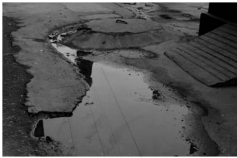
山阳路国税局家属院下水道堵塞，粪水横流没人管。 本报记者 王海燕 摄
