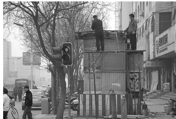
经受风吹日晒的交通岗亭近日得到了专业人员的维护。其中, 解放路与新华街交叉口、解放路与山阳路交叉口以及万方桥南端十字路口的三个投用近二十年的岗亭, 由维修人员采用新型反光材料进行了修缮。 石凯 摄
