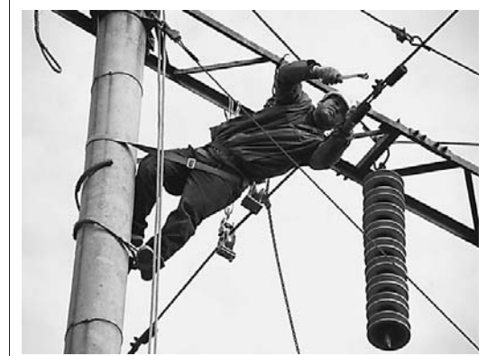
近日,博爱县电业局对县城所辖供电设备进行了全面检查,确保冬季用电安全。程刚 摄
