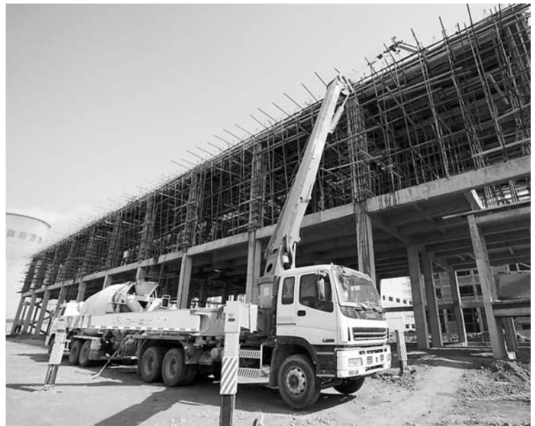
焦作市一建商品混凝土有限公司抢抓产品质量和售后服务,赢得了市场的认可,先后为一百多个工程项目提供了商品混凝土,市场占有率超过百分之二十,在我市该类产品中名列前茅。图为该公司的混凝土运输车正在我市的重点招商引项目——市健康元项目工地输送混凝土。 本报记者 董亚洲 摄
